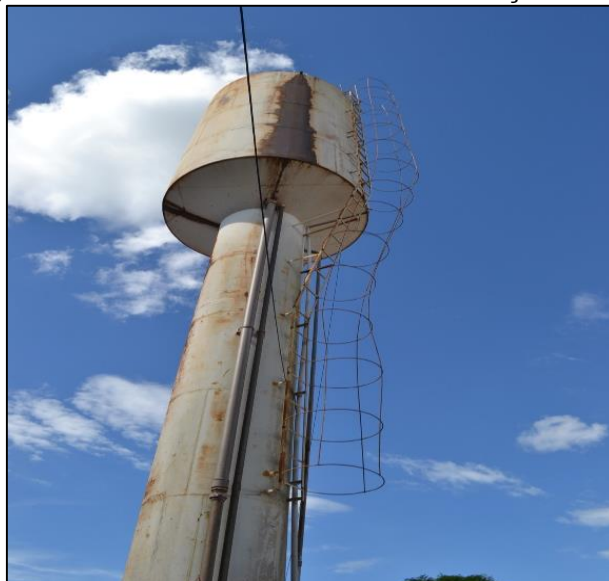
Figura 12 – Reservatório R3 Elevado no Poço SEV-002.
