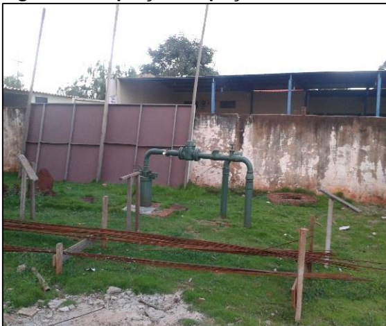
Figura 8 – Captação no poço SEV-003.
