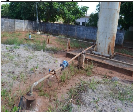
Figura 9 – Captação no poço SEV-002.
